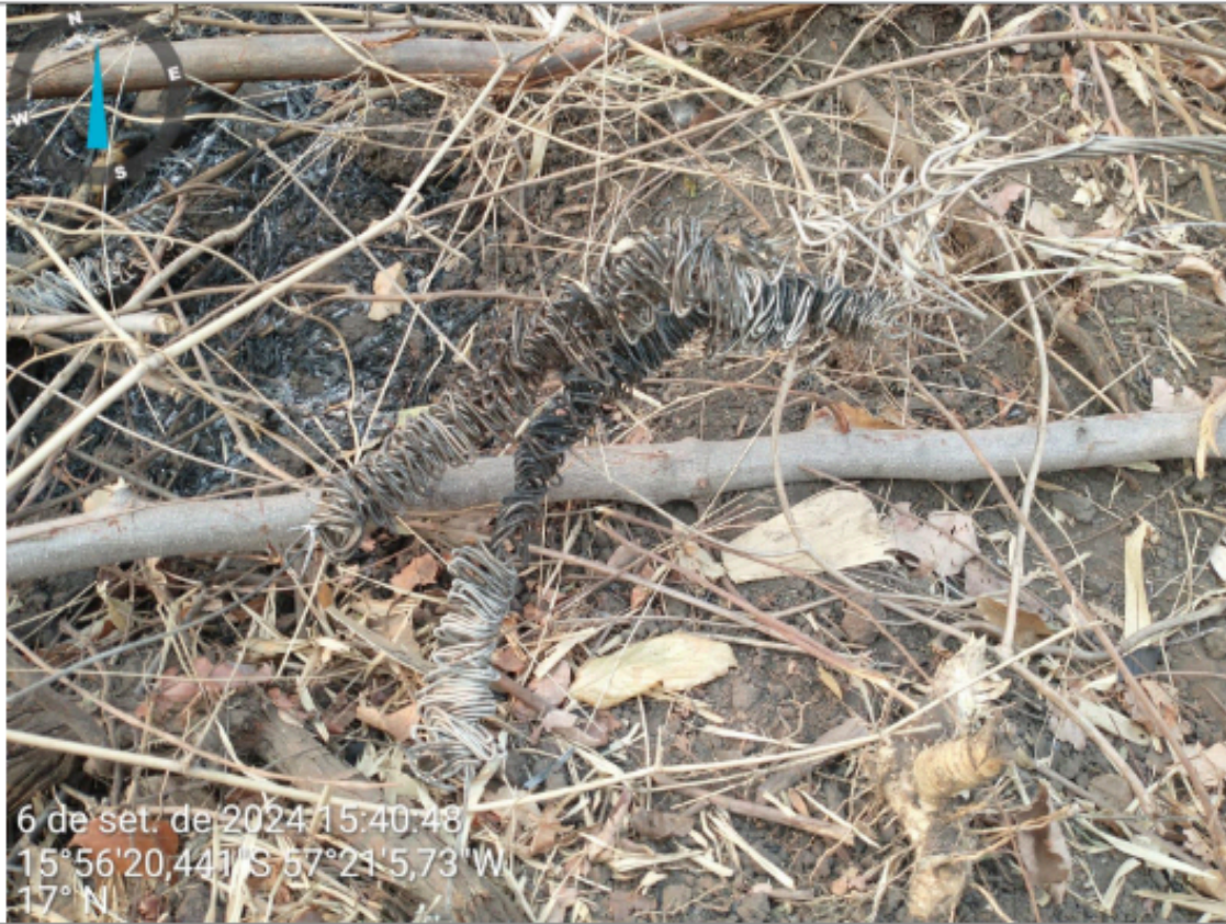
Cabo de rede elétrica retorcidos e queimados.
